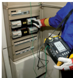
Mantenimiento terciario e industrial, diagnósticos y controles
